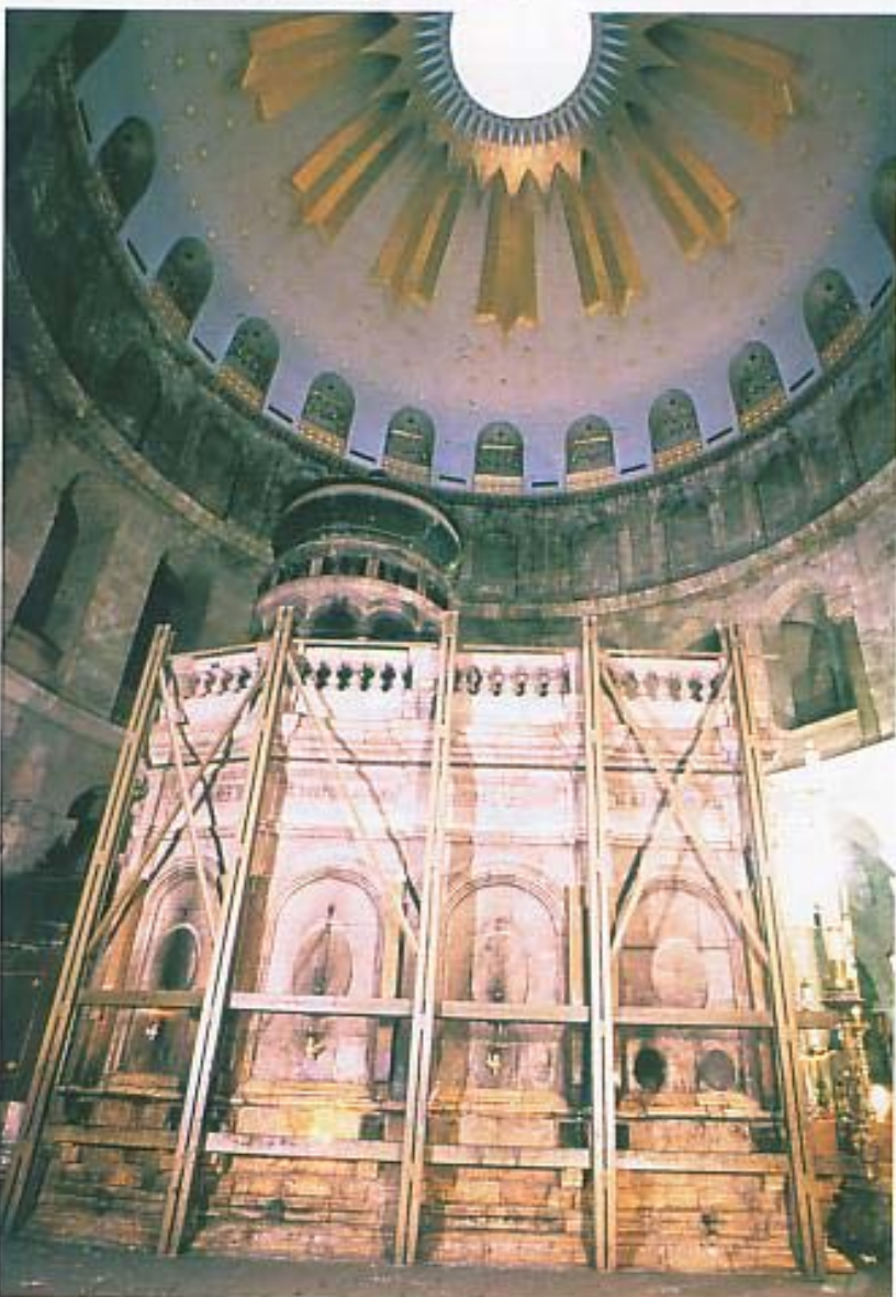
Ο Πανάγιος Τάφος, έργο του Κορνηνού (1810), υποστηλωμένος με μεταλλικά στοιχεία από τον σεισμό του 1927, και οι νέες «θρησώδεις» ακτίνες του τροχίου.
